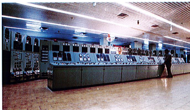
690 मेगावाट सलाल पावर स्टेशन ( जम्मू व कश्मीर ) कंट्रोल रूम
