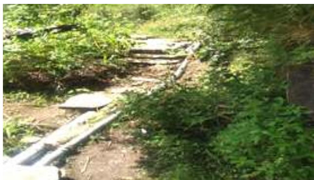
छोले नाला स्रोत से पेयजल पाइप लाइन
