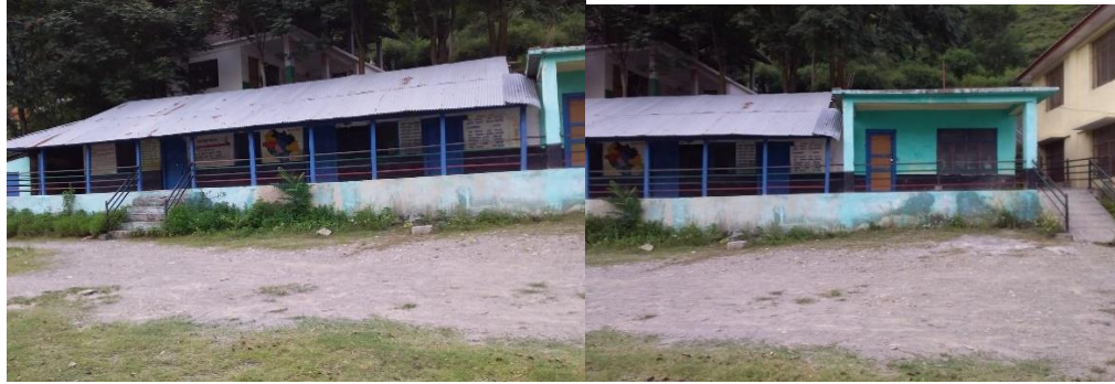
जीपीएस सारी में रेलिंग और सीढ़ियों, का निर्माण कार्य पूर्ण हुआ 2019-20में
